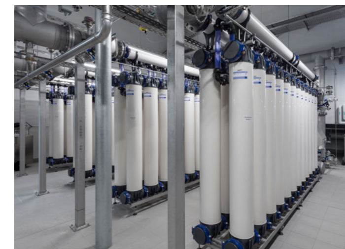
Bild 4: Die Ultrafiltrationsanlage sorgt für höchste Wasserqualität.
